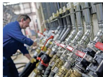
ROWE verfügt über eine der modernsten Abfüllanlagen in Europa
