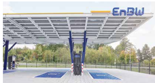
Auch die Gestaltung von Ladesäulen muss wohlüberlegt sein
