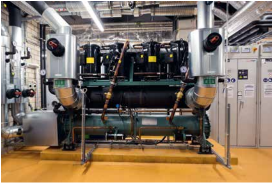
Auch im Industriebau verfügt Mahr über langjährige Erfahrung und großes Know-how, hier eine Kältemaschine
