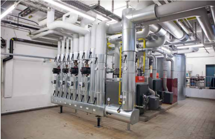
Für kommunale Einrichtungen wie Schulen, Kindergärten oder Seniorenheime ist die dezentrale Energieversorgung über Blockheizkraftwerke mittels Contracting die ideale Lösung
