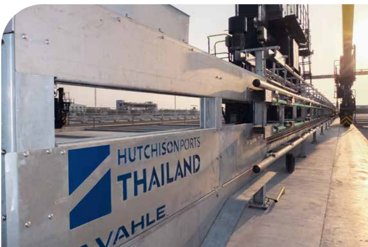
In Laem Chabang in Thailand werden, dem sogenannten ERTG-Kran, vollautomatisch aus dem Leitstand gesteuert – ermöglicht durch VAHLE-Systemlösungen
