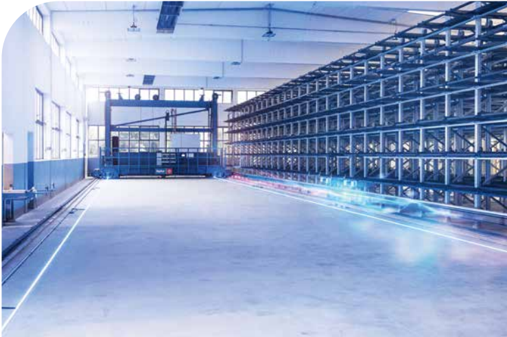
Im eigenen Wabenlager versorgen VAHLE-Systeme bestehend aus Positionierung, Datenübertragung, Steuerung und Energiezuführung das Regalbediengerät
