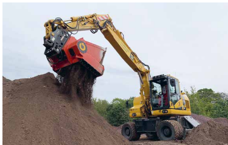
Alles an einem Ort: Erde ausheben, trennen, Wiedereinbau – Allu steht für umweltfreundliche Erdarbeiten
