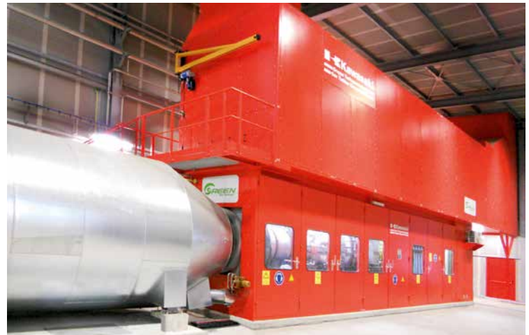
Kraftpaket: Das Gasturbinen-Generator-Aggregat GPB80D hat eine elektrische Leistung von 7.810 kW bei einem elektrischen Wirkungsgrad von 33,6%
