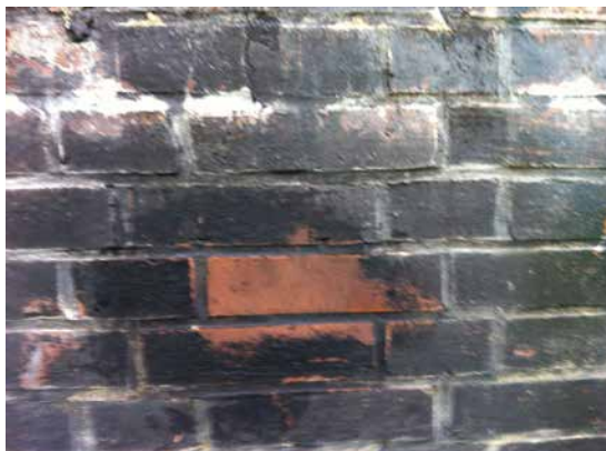
An dieser Fassade wird der Unterschied zwischen gereinigter und verschmutzter Fläche direkt sichtbar
