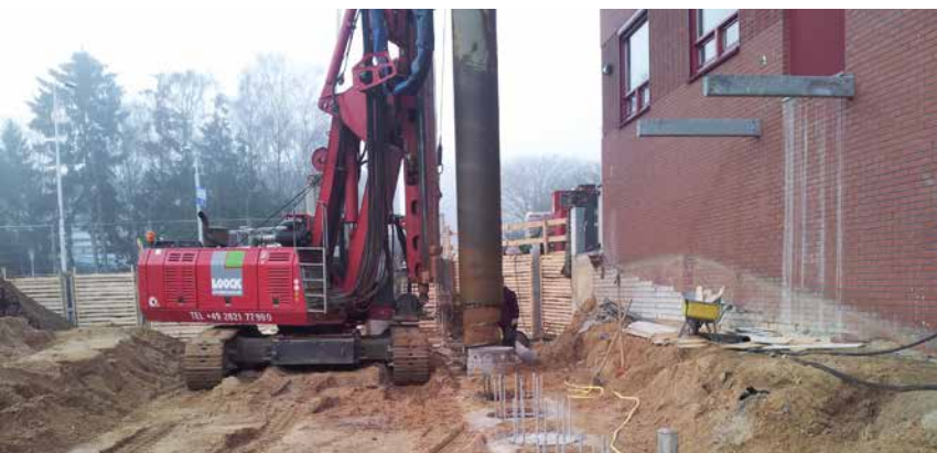
Für alles gewappnet: Der Maschinenpark ist mit allen für Spezialtiefbauprojekte erforderlichen Geräten ausgestattet
