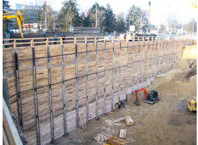
Das muss halten: Sobald es tief hinab geht, ist der Service von Looock Spezialtiefbau gefragt
