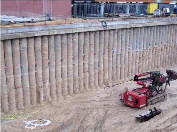
Sicherheit auf jeder Ebene: Baugruben inmitten bebauter Grundstücke stellen besondere Anforderungen an den Spezialtiefbau
