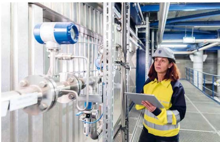
Kompletter Service: Die MARTIN GmbH steht ihren Kunden über den gesamten Lebenszyklus einer Anlage zur Seite
