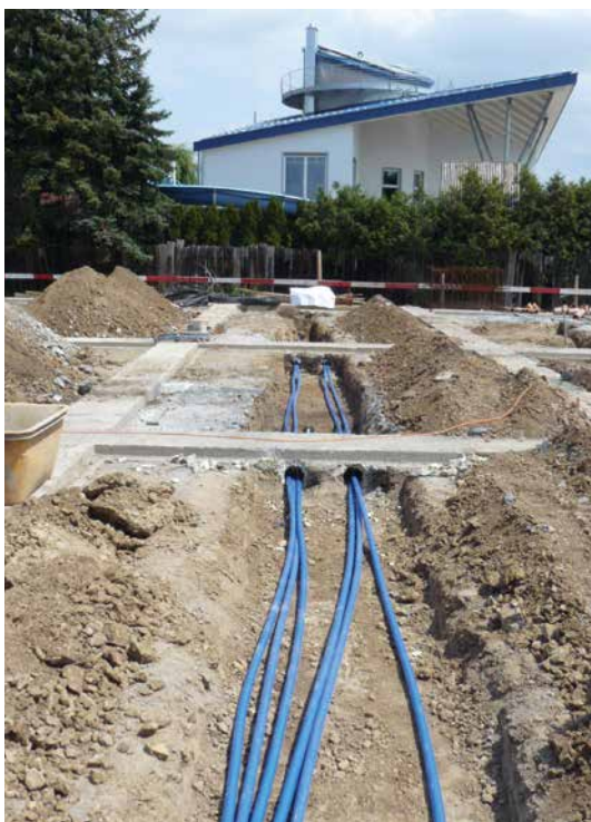
Unter, auf und in der Erde tätig: HPC bietet ein riesiges Portfolio an Ingenieurdienstleistungen, wie Geothermie (links), Baugrundgutachten, Geotechnik und noch viel mehr
