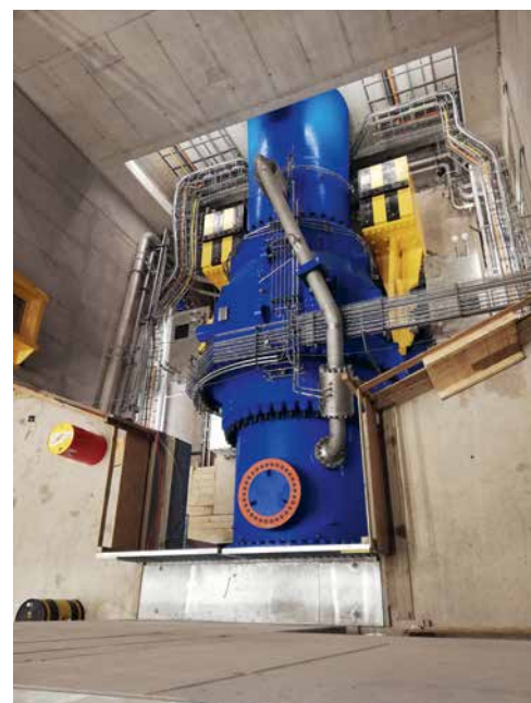
Kugelschieber des Hochdruck-Pumpspeicherkraftwerks Obervermuntwerk II
