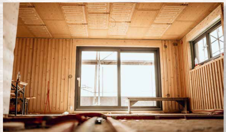
Beispiel einer naturbo-Deckenheizung im Holzhaus
