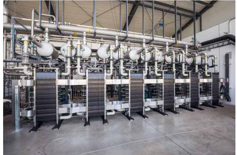
Mit innovativen Technologien wird bei voestalpine grüner Wasserstoff erzeugt – 6 MW
