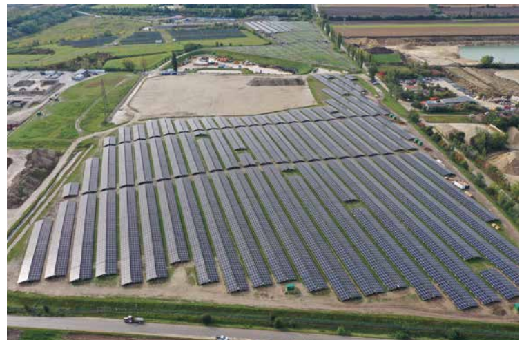
Am OMV-Standort Schönkirchen, Niederösterreich entsteht Österreichs größte Freiflächen-Photovoltaikanlage
