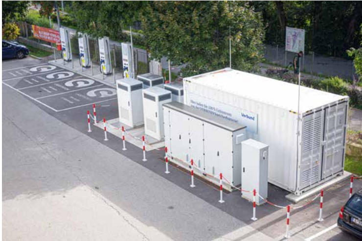
Ein guter, grüner Mobilitäts-Mix: Hochleistungsladestationen für E-Mobilität in Kombination mit Batteriespeichern
